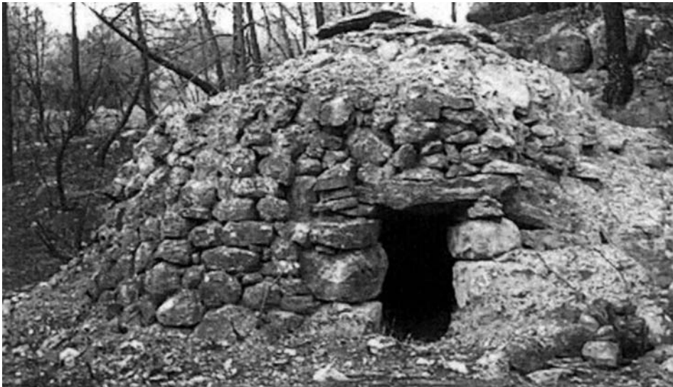
La barraca de l'Armengol, després de l'incendi.
